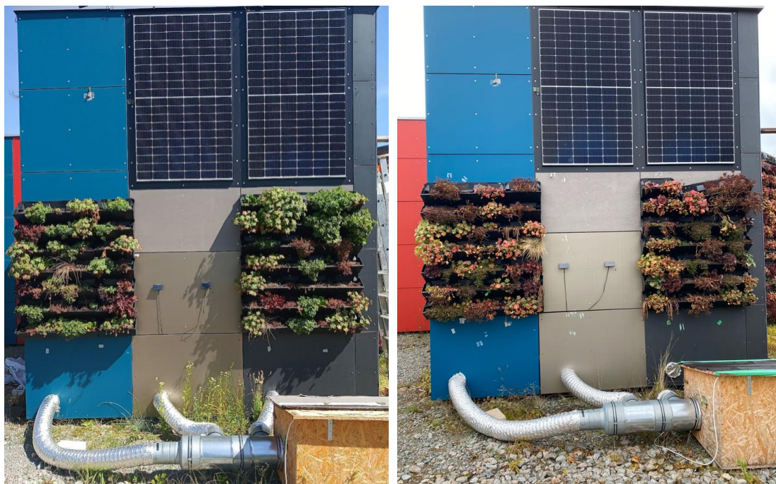
Doplňkové prvky CHF – FV elektrárna, zelená fasáda (vlevo červen, vpravo listopad) s řízeným větráním; v prostředním zlatém modulu jsou osazené mini FV panely pro napájení datalogerů ve fasádě (hodnoty se zobrazují v software)
