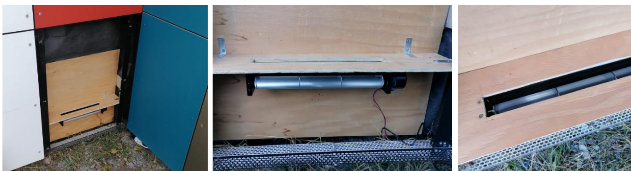
Tangenciální ventilátor ve větrané mezeře na dřevěné konstrukci
